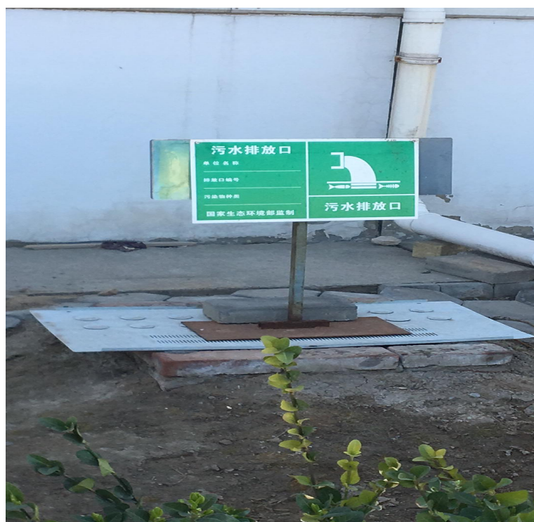
图 2-2 厂区内污水总排口
